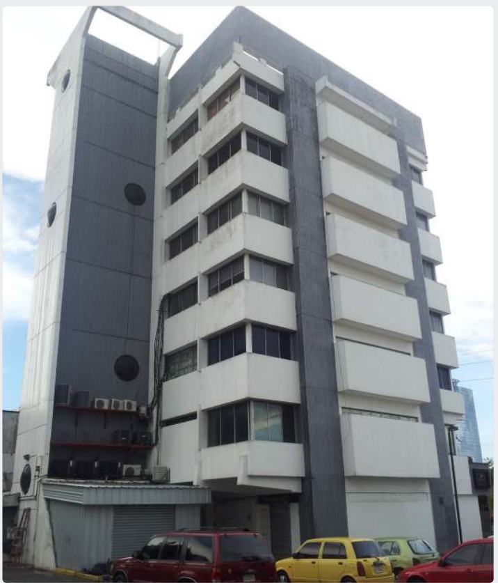
Núcleo de circulación y fachada posterior. Condensadoras ancladas al paramento y marquesina de chapa sobre estructura añadida.
